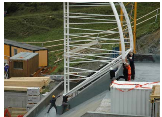
Die bis zu 13 m hohen und 3,8 t schweren Konstruktionen wurden mit dem Heli von Fideris nach Arosa geflogen und dort direkt auf ihre vorbereiteten Fundamente gesetzt.
