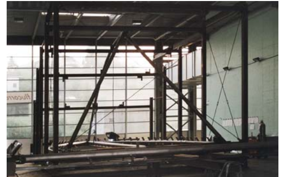
In der eigens gemieteten Industriehalle in St. Gallen wurde ein Metall-rahmen aufgebaut, der als Schablone die Fixpunkte für die Montage der Rahmenelemente diente.
