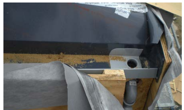
((Datei: 2_Residence_Grevenmacher_10)) Rückseitiger Entwässerungsanschluss der diagonalen Fassadenrinnen
