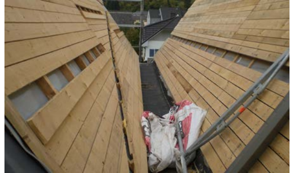
((Datei: Residence_Grevenmacher_18)) Belüftungssituation der beiden Gebäudekörper, Ausführung der innenliegenden Rinne
