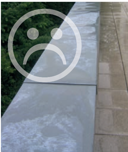
Zinkhydroxidbildung durch unzureichendes Gefälle
